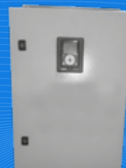
Para bombeo solar
