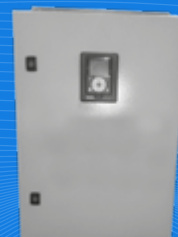
Para bombeo solar
